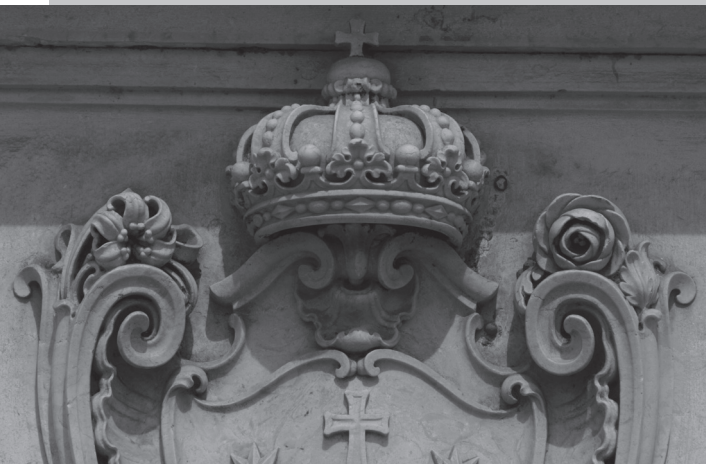
À esquerda, arco de descarga arruinado. Acima, detalhe da portada lateral da Igreja do Carmo de Alcântara
